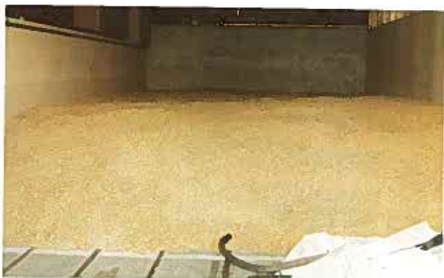
Photo 5 : Cellule de séchage de grains équipée d'un plancher perforé (installation de Mme Kollsgard en Norvège).
