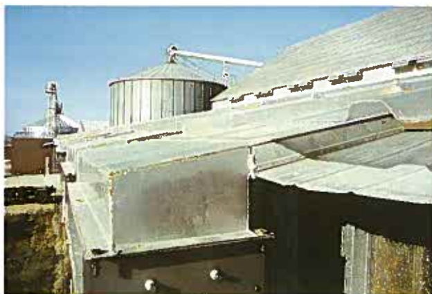
Photo 2 : Capteur toiture avec effet de serre sur l'installation séchage solaire de grains de la coopérative de Salvagnac (France)
