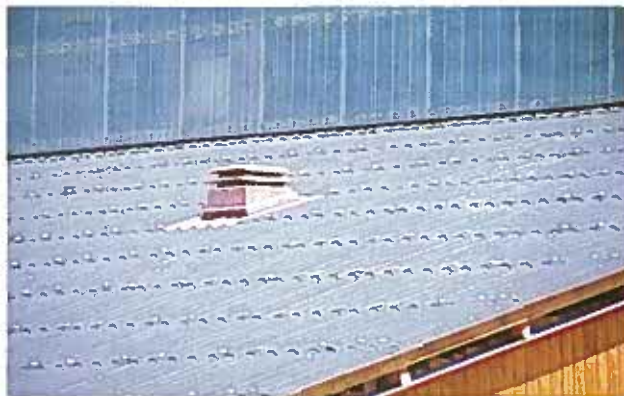
Photo 1 : Installation de M. PROVENT, (France) Capteur de type 1. L'air est aspiré par un pignon et récupéré sur l'autre pignon. De nombreuses variantes existent sur la circulation de l'air : gaine de récupération centrale, aspiration par le faîtage ou la gouttière, ...
