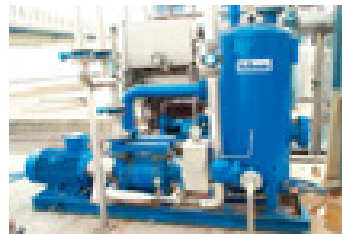
Surpresseur fonctionnant au biogaz utilisé pour le décollement des boues sur lits fixés.
