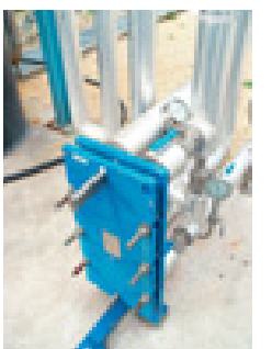
Échangeur de chaleur à plaques, eau chaude/effluents entrants - Confiterie MATERNE
