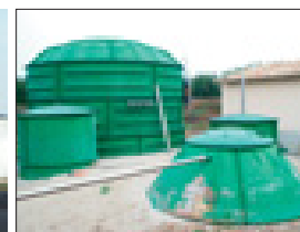
Cave Vinicole Château Bonnet, à Grézillac (Gironde) Le méthaniseur au fond, les bassins d'aération et de clarification Au premier plan, le local chaudière
