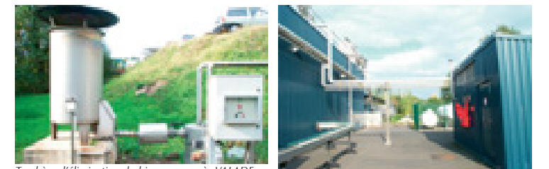
Torche d'élimination du biogaz en excès VALADE
