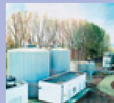
Unité de co-digestion à Behringen (Allemagne)
