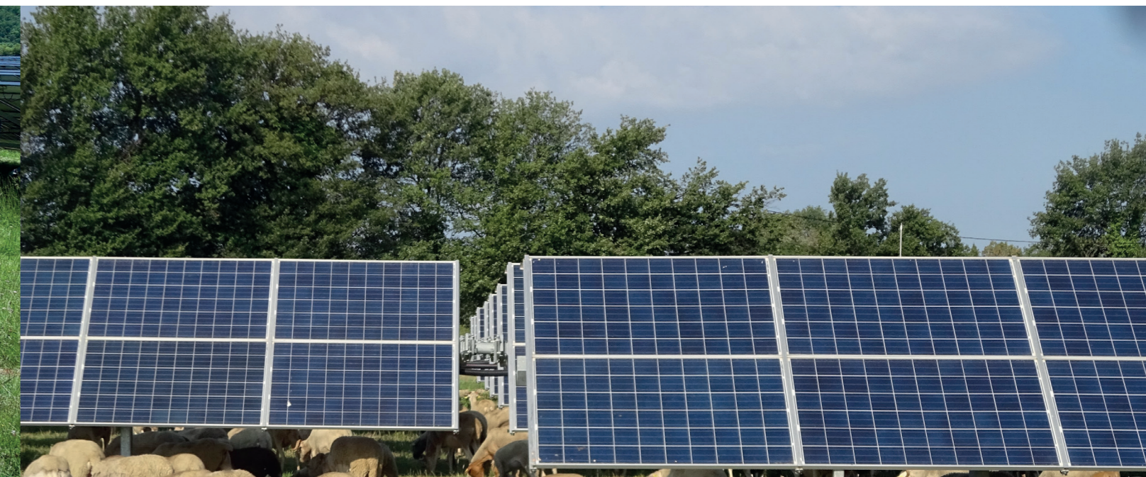
parc photovoltaïque du Soler (66)
