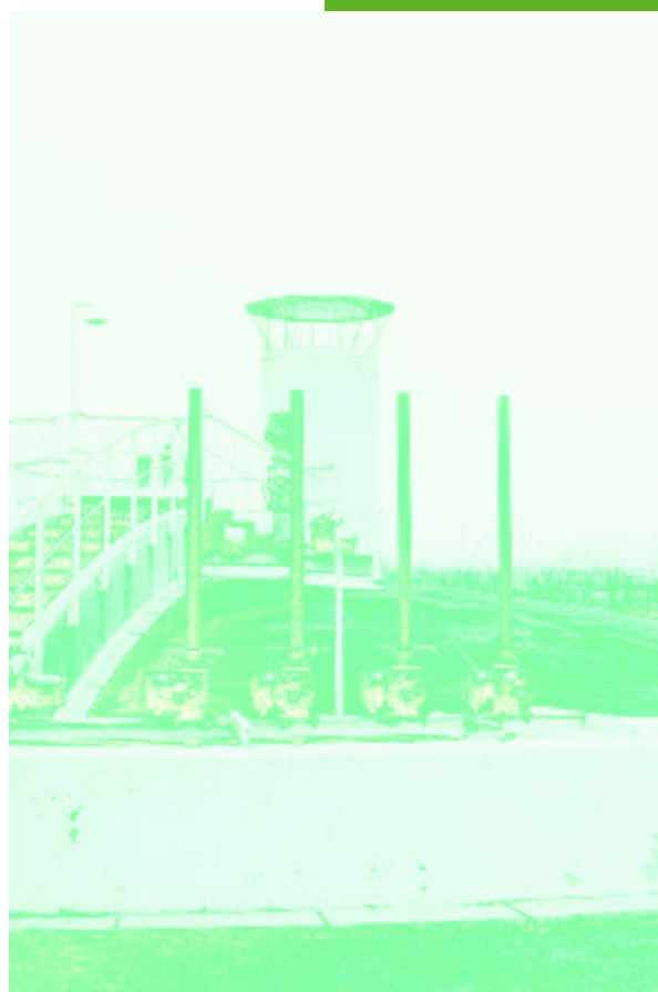
Digesteur et torchère, SIAAP Seine-Amont, Valenton.
